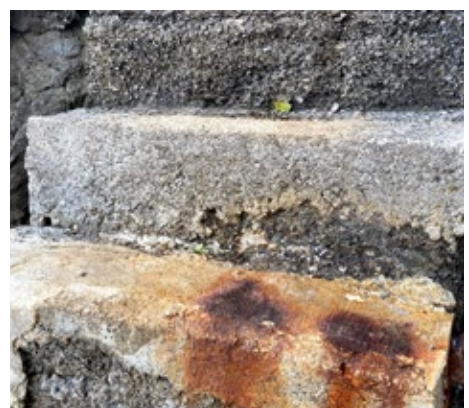
Ataque por cloruros y abrasión mecánica del agua de mar
