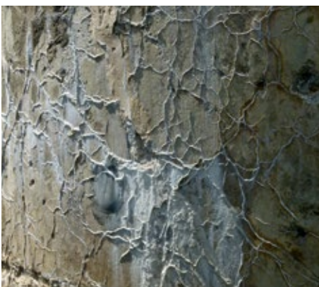
Lixiviación de la cal causada por el agua blanda
